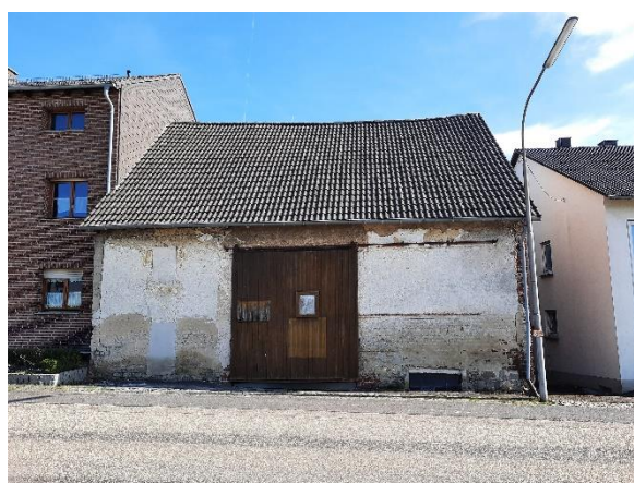
Abbildung 95: Nebengebäude mit erheblichem Sanierungsbedarf an der Hauptstraße / K 176 / ehemalige B 255 II
