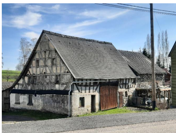
Abbildung 94: Nebengebäude mit erheblichem Sanierungsbedarf an der Hauptstraße / K 176 / ehemalige B 255 I
