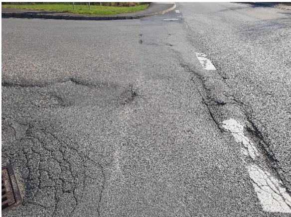
Abbildung 178: Sanierungsbedarf an der Kreuzung von Hauptstraße / K 176 / ehemalige B 255 und K 80 in Richtung Meudt
