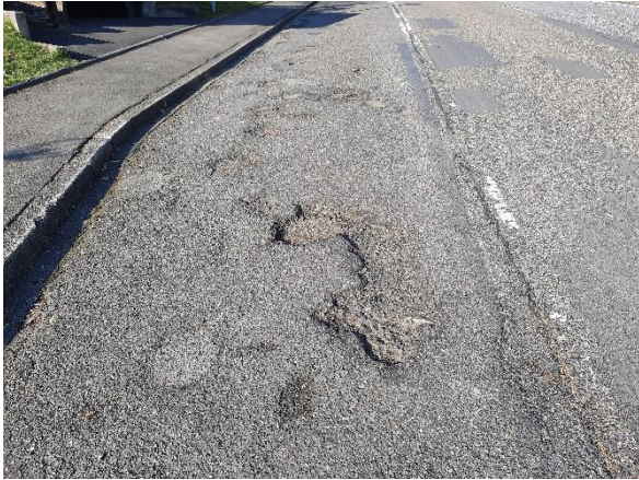
Abbildung 176: Sanierungsbedarf an der Hauptstraße / K 176 / ehemalige B 255 im Bereich der Bushaltestellen
