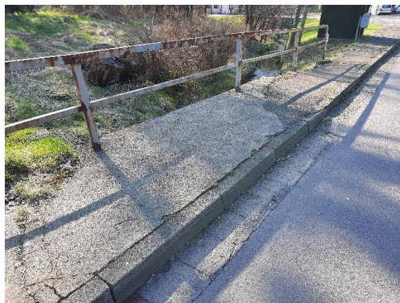
Abbildung 40: Brückenschäden an der K 80 Richtung Meudt II
