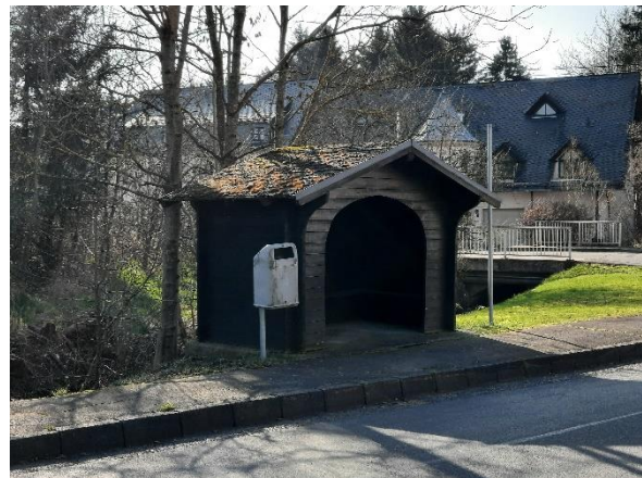
Abbildung 164: Nicht mehr genutzte Bushaltestelle an der K 80 Richtung Meudt
