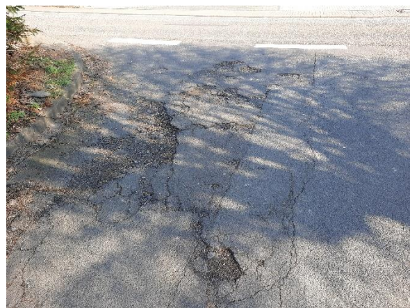
Abbildung 181: Sanierungsbedarf in der Dammstraße
