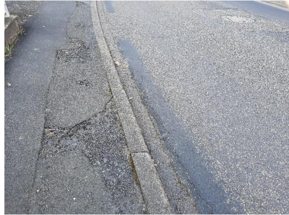
Abbildung 177: Sanierungsbedürftiger Bürgersteig an der Hauptstraße / K 176 / ehemalige B 255
