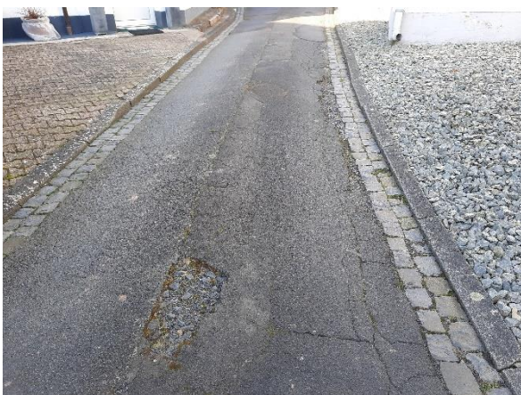
Abbildung 180: Sanierungsbedarf in der Brückenstraße
