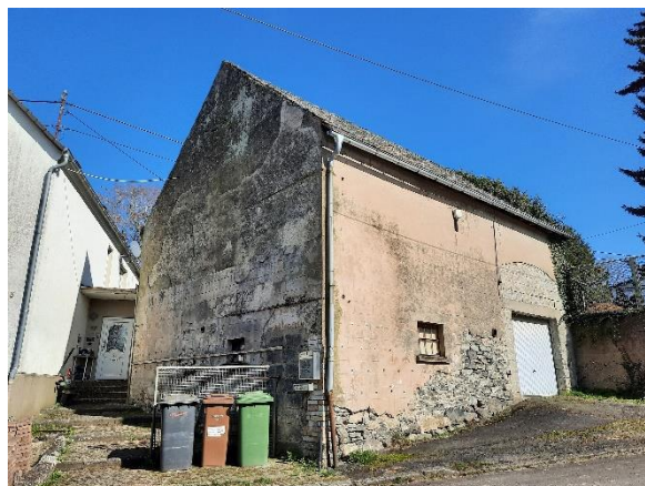
Abbildung 93: Nebengebäude mit erheblichem Sanierungsbedarf in der Forststraße
