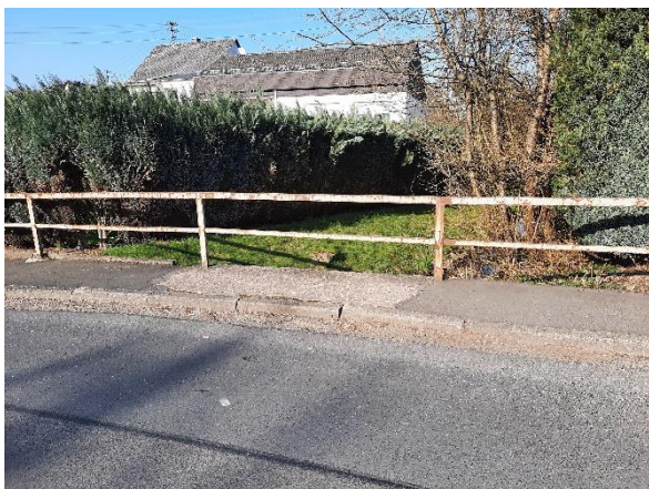
Abbildung 39: Brückenschäden an der K 80 Richtung Meudt I
