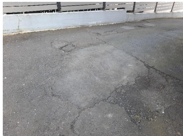
Abbildung 140: Sanierungsbedürftiger Hof des Rathauses
