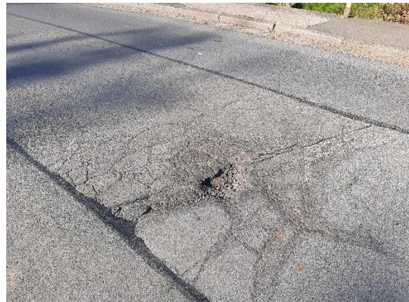
Abbildung 179: Sanierungsbedarf an der K 80 in Richtung Meudt
